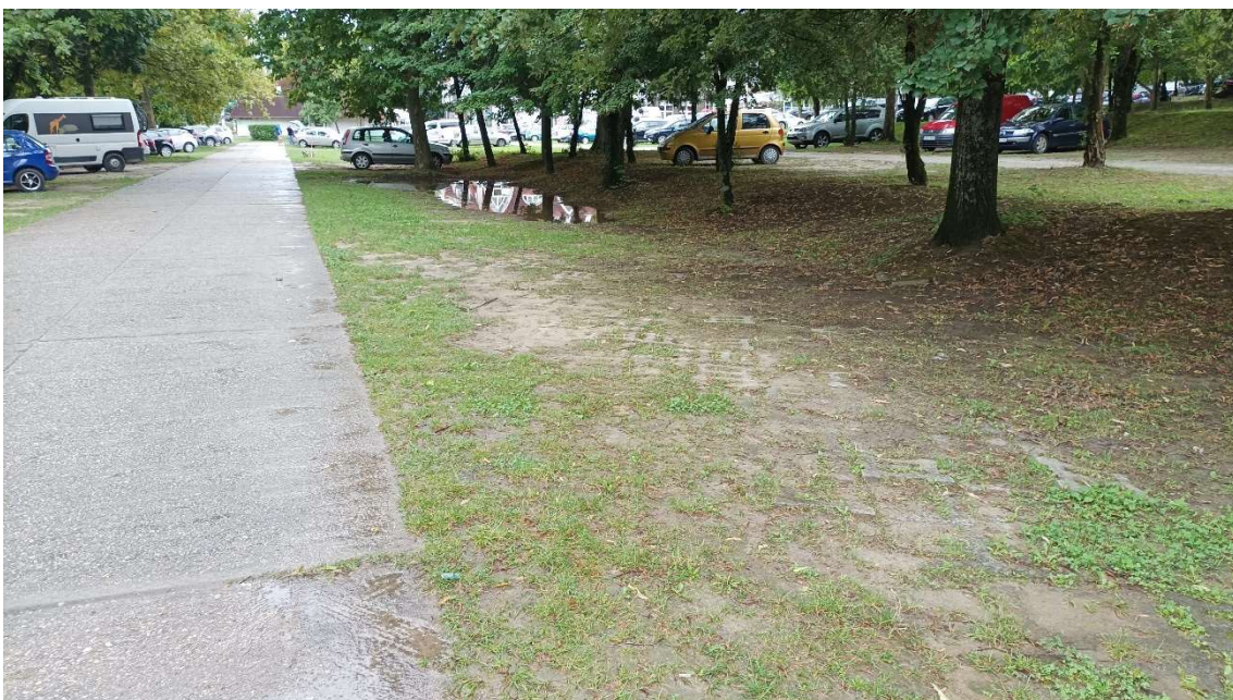
Leromlott állapotú parkolóburkolat
